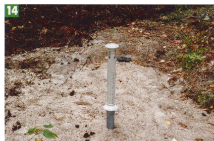
14 Наружу над септиком выводится вентиляционный канал.
