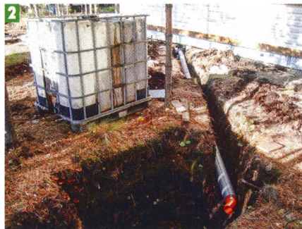
2 Канализационные стоки из дома отводятся по оранжевым канализационным трубам, которые утеплены снаружи пенополиэтиленом.
